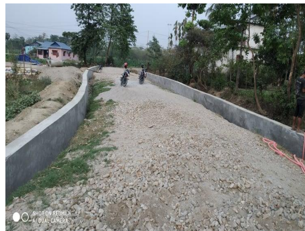
वडा नं ९ हर्चना चोकमा निर्माण भएको प्लम वाल
